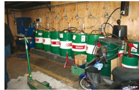
Direkte sug/ rørføring fra råvarerbeholder til brugssted betyder minimering af spild ved håndtering
