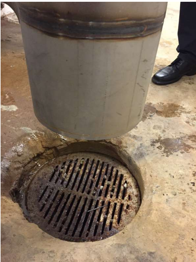
Figur 6. Afstand mellem afløbsrør og rist.
