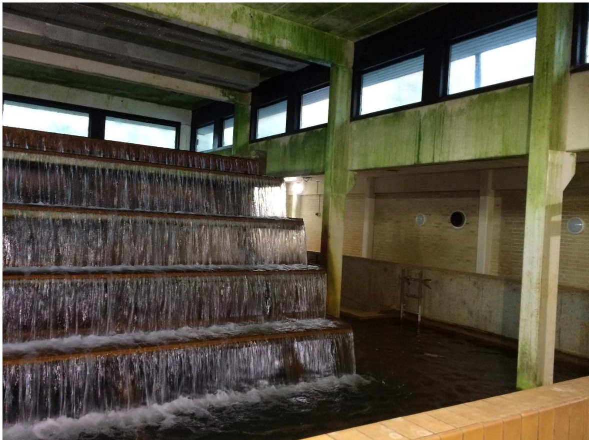
Algevækst i iltningsskammer.
